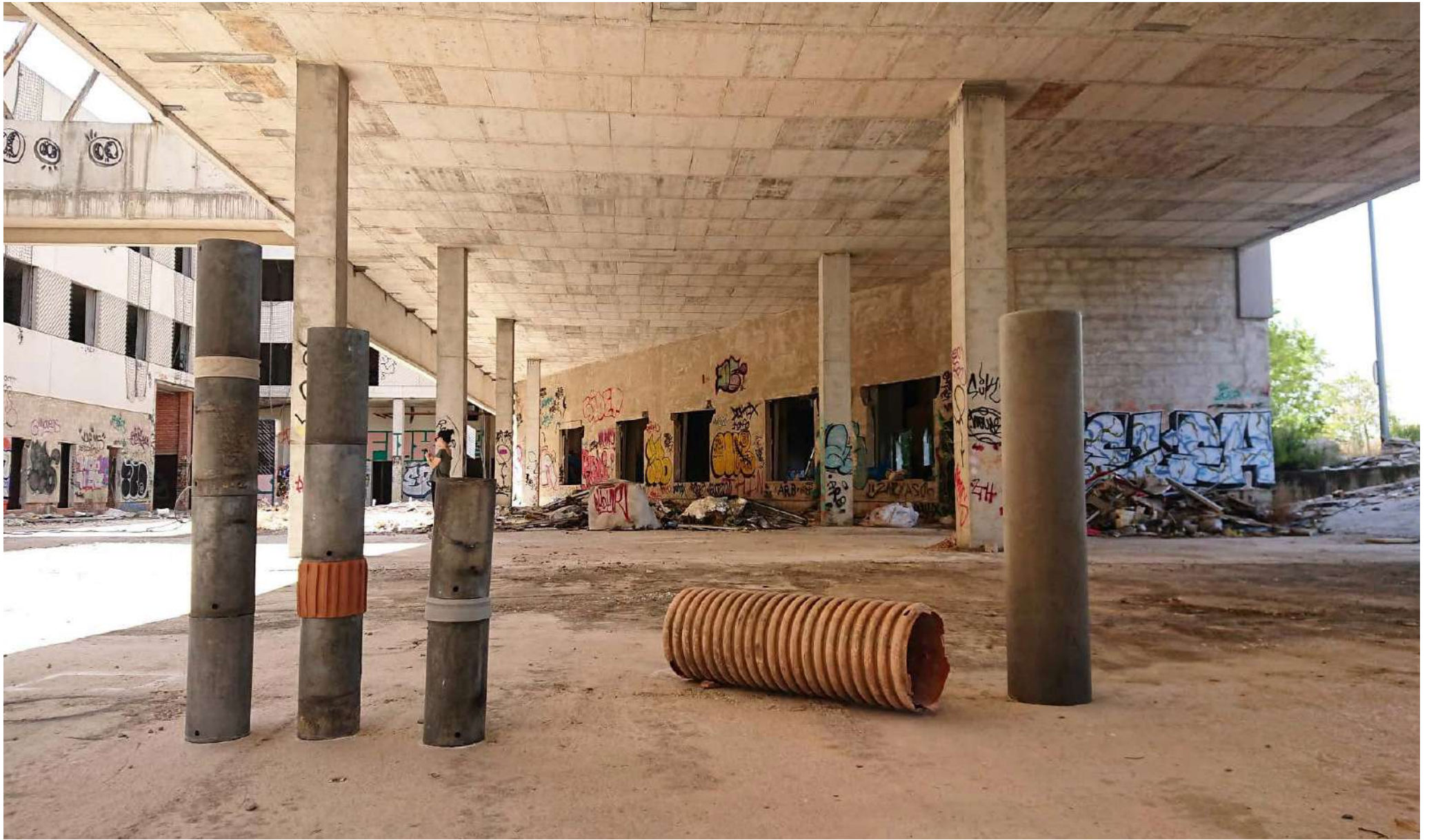
NF / Aragón Park 2020 Vistas de instalación Edificio abandonado en las afueras de Madrid
